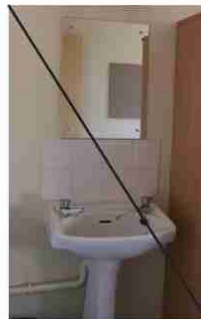
Плохо Раковина с пьедесталом. Фартук из плитки
