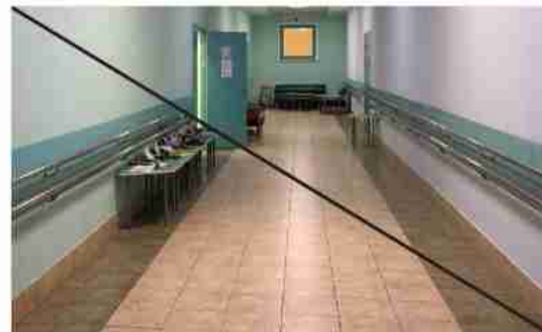
Плохо Керамогранитная плитка с крупными швами
