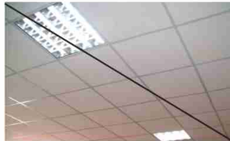
Плохо Открытые направляющие
