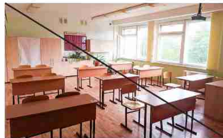
Плохо Линолеум под дерево
