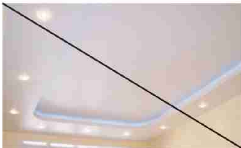
Плохо Многоуровневые гипсокартонные конструкции
